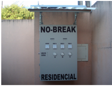
Fig. 17. Fotografia do Protótipo do No-Break instalado.
